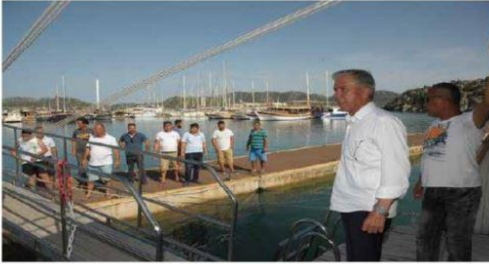
Üçağız Yüzer iskelesi kısa sürede tamamlandı. İMEAK DTO Yönetim Kurulu Başkanı Sn. Tamer KIRAN'ın yakın ilgisi ve Antalya Şubesi Yönetim Kurulu Başkanımız Ahmet ÇETİN'in gayretleri ile Üçağız iskelesinin montajı 2 hafta gibi kısa bir sürede tamamlanmıştır.
